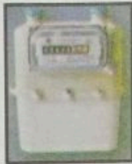
Fig: 5.11 Gas meter
